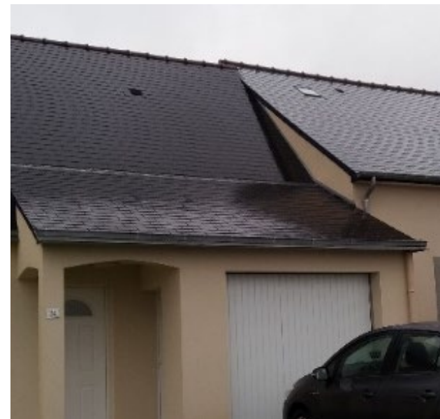
Exemple de raccordement mitoyen refusé
